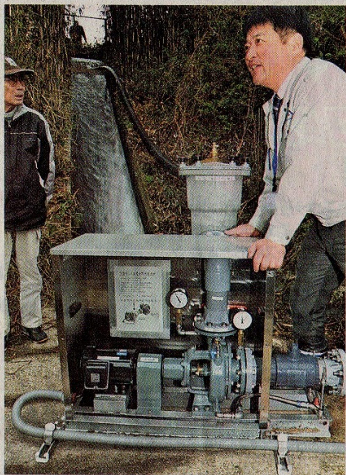
水路近くに設置されたマイクロ水力 発電装置 ＝出水市高尾野
